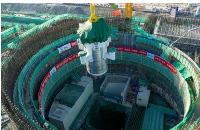
Il modulo centrale del reattore nucleare modulare Linglong One, il primo SMR commerciale al mondo, installato in Cina nel 2023 dalla China National Nuclear Corporation (CNNC) (Fonte: American Nuclear Society)
